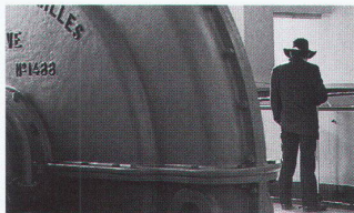
17.30 Centrale hydroélectrique Chandoline
