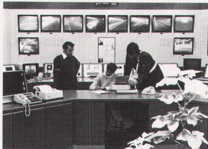
Wand- und Pult-Abdeckungen aus KELLCO in der Überwachungszentrale Göschenen.
