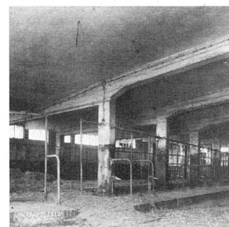
(1) Hofplatz von Süden mit «Kuhhaus» und Scheune (2) Grundriss «Kuhhaus» (3) Inneres des «Kuhhauses»
