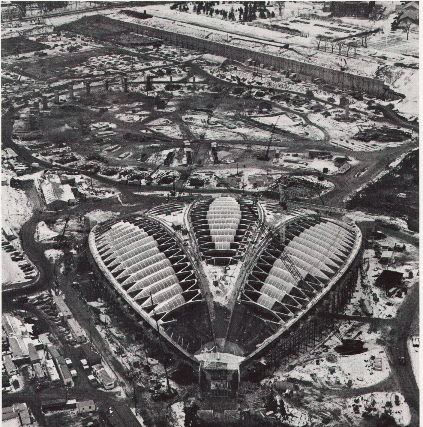
En bas, la structure du vélodrome, en haut, les fondations stade: état des travaux en novembre 1974 (Photos: Sipa-Press)
