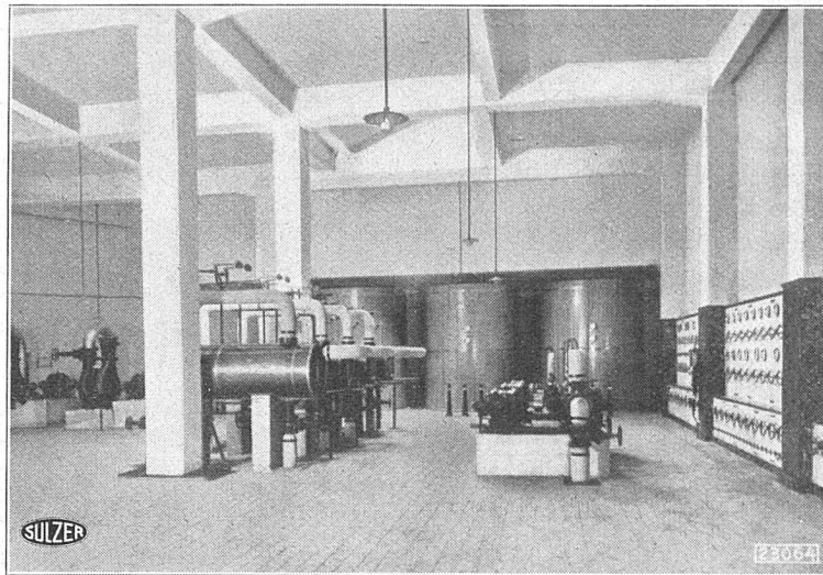
«Residence Palace» Brüssel, ausgerüstet mit Sulzer-Fern-Warmwasserheizungs-, Fern-Warmwasserbereitungs- und Ventilationsanlage. - Heizzentrale.
