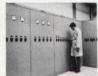
Steuerschränke für Sanitär- und Lüftungsanlagen im Hotel Zürich
