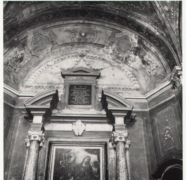
5 Alter Zustand der Seitenkapelle La même chapelle latérale avant la restauration Previous condition of the same chapel
