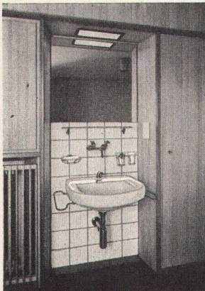
Sanitäre Installationen: Toilettenanlage im Zimmer
