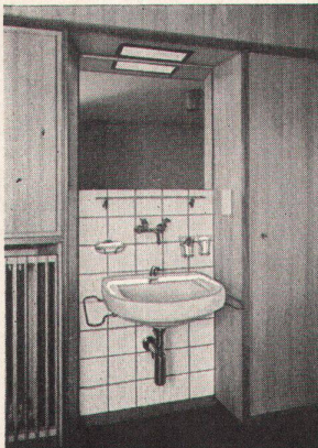
Sanitäre Installationen: Toilettenanlage im Zimmer
