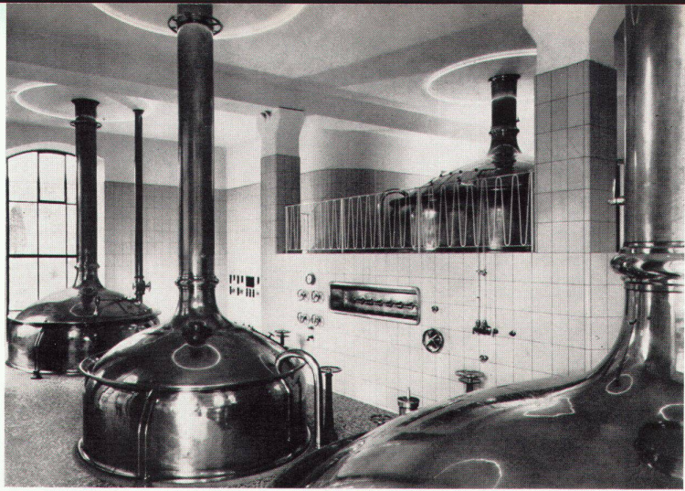
Heißwasserbeheizte Braupfannen in einer Bierbrauerei
