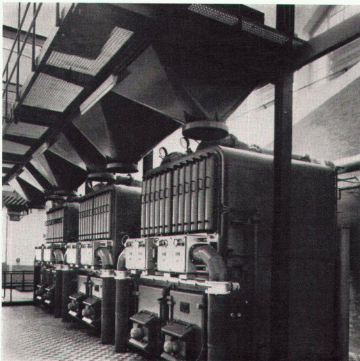
Sulzer-Taschenkessel zur Erzeugung von Warm- und Heißwasser
