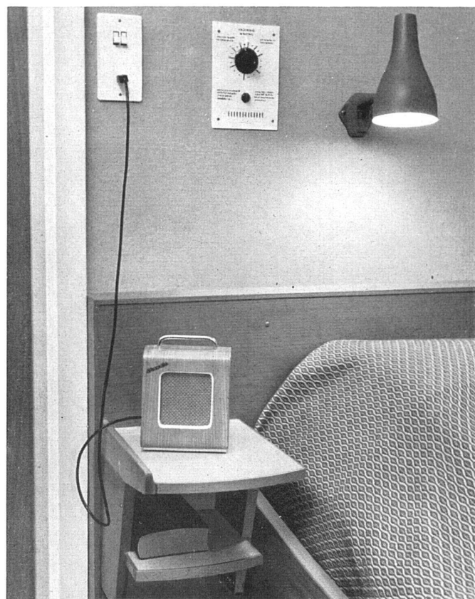
Internes Telephon für Stubenmädchen, automatische Weckanlage vom Gast einstellbar | Téléphone de service interne, réveille-matin automatique | Internal service telephone, automatic alarm-clock
