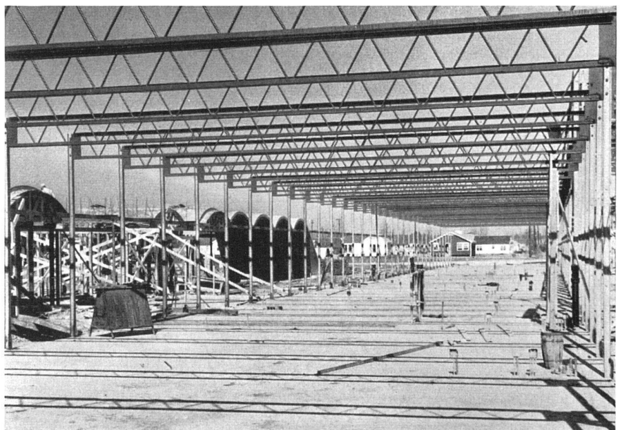
Das leichte Konstruktions-Skelett | L'école en état de construction, ossature métallique légère | The light steel skeleton
