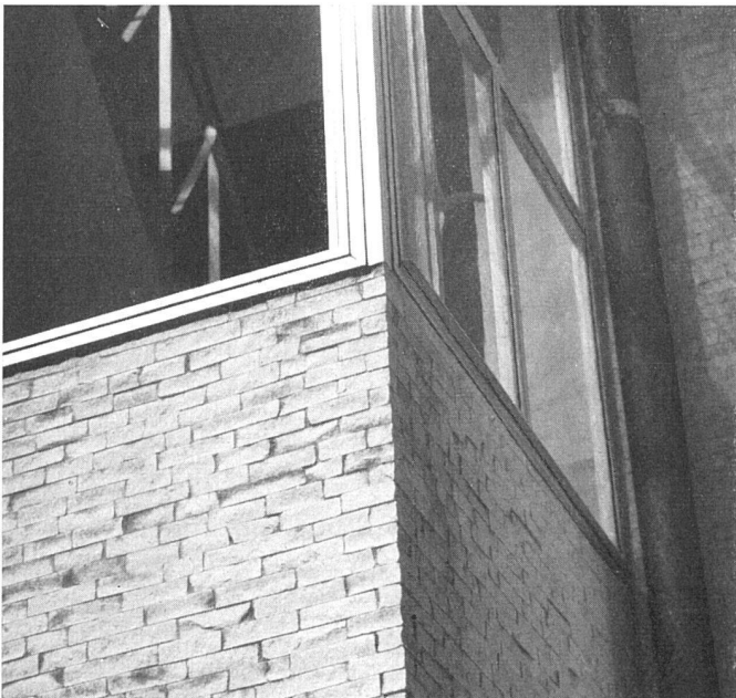
Fassadenverkleidung. Maschinengebrosene Carrara-Marmorstücke, 70 × 35 mm, 30 bis 50 mm tief | Les façades sont revêtues de petites pièces de marbre de Carrare | The elevations are clad with small pieces of Carrara marble
