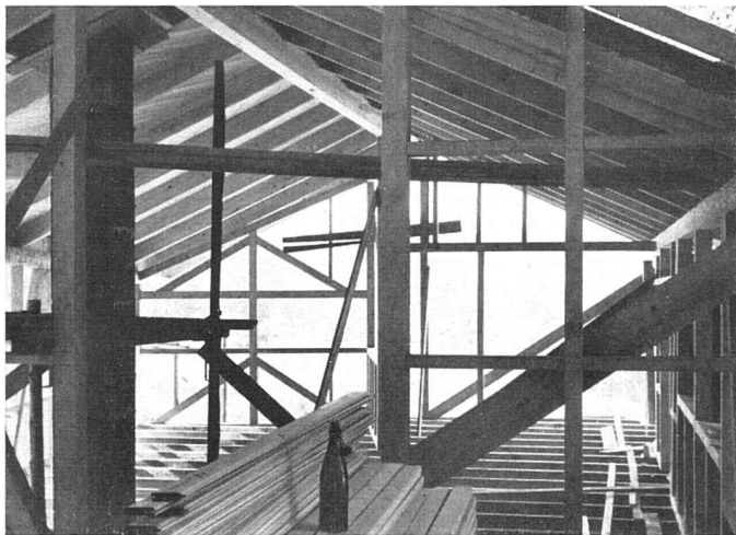
Schon der Rohbau zeigt die künftige Form des Innenraumes | La charpente indique déjà la future forme de l'intérieur | In the unfinished construction the future form of the interior can already be seen
