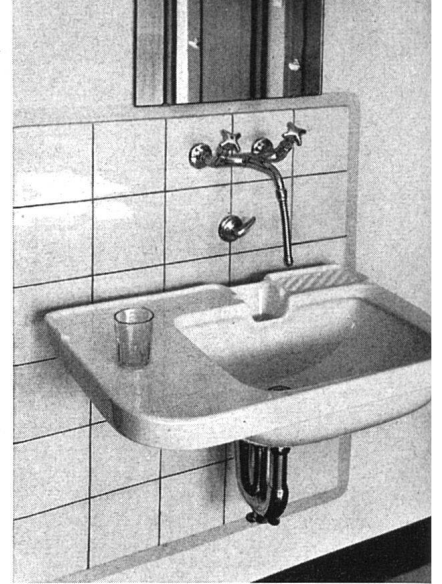
Abb. 81 Normaltoilette AKZ mit Abstellfläche (Fabrikat Laufen; Armatur Karrer, Web Co., siehe «Werk» Nr. 5 1946 und «Installation» Nr. 4 1946). Gleiche Toilette Abstellfläche siehe Abb. 79. Für beschränkte Platzverhältnisse hat die AKZ ausserdem Kleintoilette (Fabrikat Laufenburg) gesch
