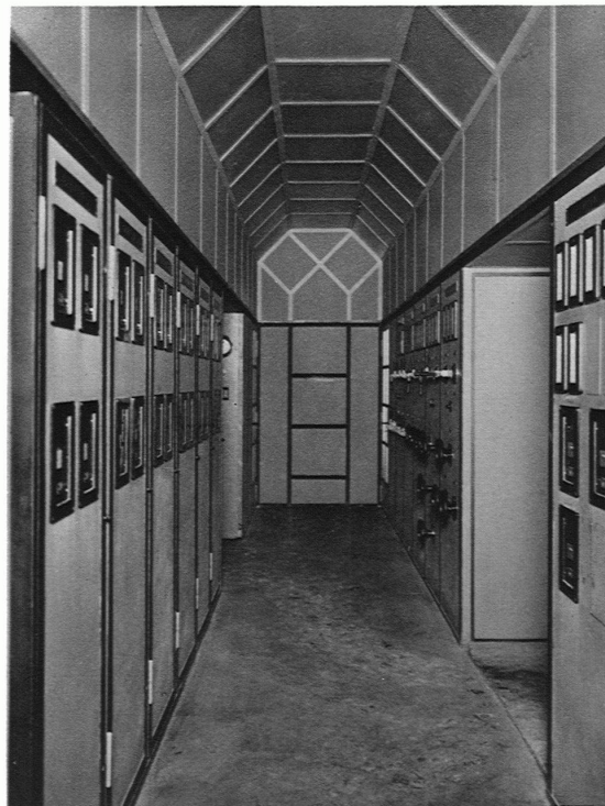
36. KOMMANDORAUM SIEBENEN KORRIDOR DER EIGENBEDARFSANLAGE
