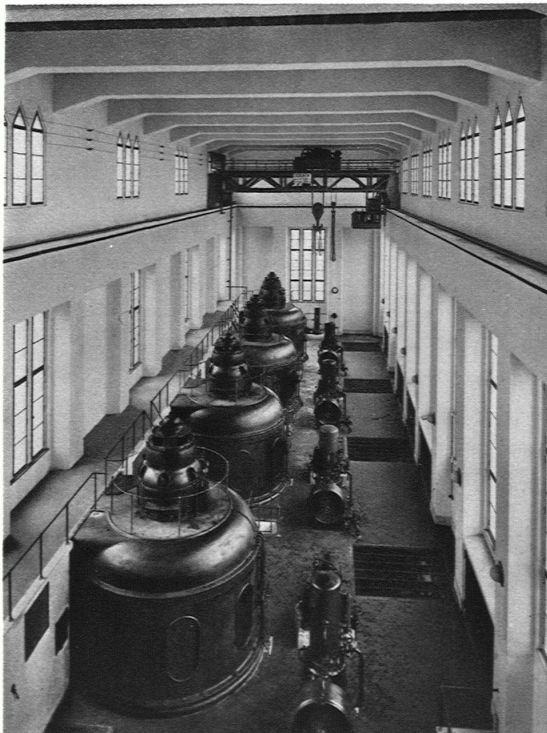
32. ZENTRALE SIEBEN / MASCHINENHAUS Saal mit 4 Einheiten zu 16000 PS
