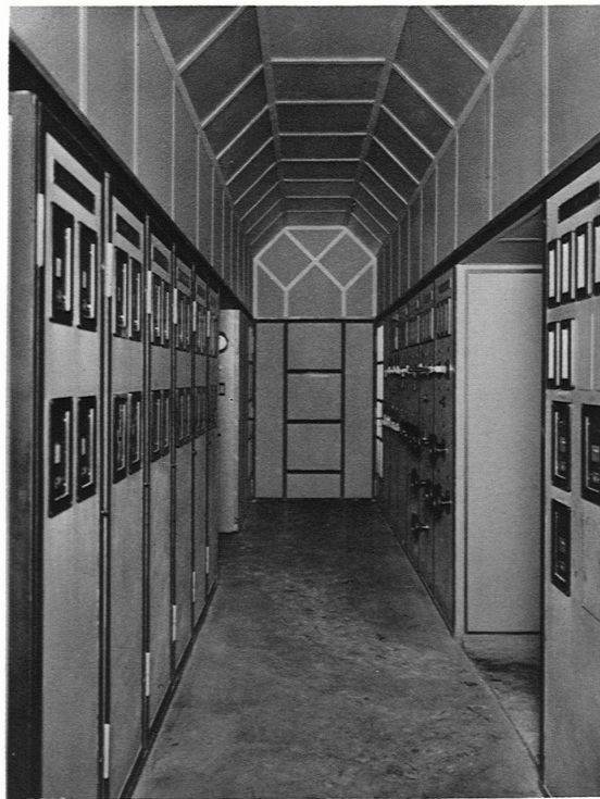
36. KOMMANDORAUM SIEBENEN KORRIDOR DER EIGENBEDARFSANLAGE
