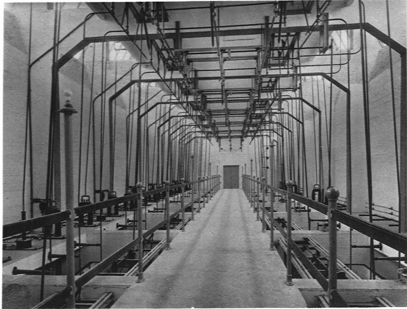
31. SCHALTHAUS SIEBEN 50-kV-TEIL
