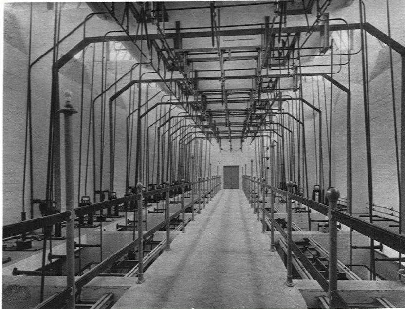
31. SCHALTHAUS SIEBEN 50-kV-TEIL
