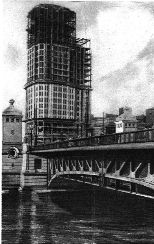
DER BUREAUTURM DER »CHICAGO TRIBUNE« WÄHREND DES BAUES Ergebnis eines internationalen Wettbewerbes
