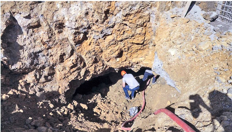
Fig. 5: Freigelegter Zugang zum Karsthohlräum (Bild Th. Rüegg, 04.08.2017).
