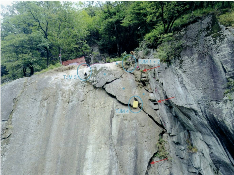
Fig. 3: Detailaufnahme der instabilen Felsplatten (nach Entfernung der Lockergesteinsüberdeckung): Die roten Pfeile zeigen die Lage der offenen Hauptkluft im Süden des grossen massigen Felskompartimentes (links). Die blauen Kreise weisen auf die Lage und Nummern der Telejointmeter (TJM) hin. Mit den Sternen sind die vier wichtigsten instabilen Felsplatten bezeichnet.
