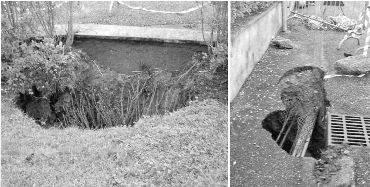
Fig. 2: Erdfall unter der Grenzmauer eines Gartens (Bild links) zum Gehsteig einer Quartierstrasse (Bild rechts). Der Einsturz erfolgte spontan und ohne irgendwelche Vorwarnung durch frühere Vorkommnisse ähnlicher Art in der Region. Der Untergrund besteht aus Elsässer Molasse, die Malmkalken überlagert ist. Als Ursache werden Karsthohlräume im Malm vermutet, die sich über einen längeren Zeitraum gebildet haben.
