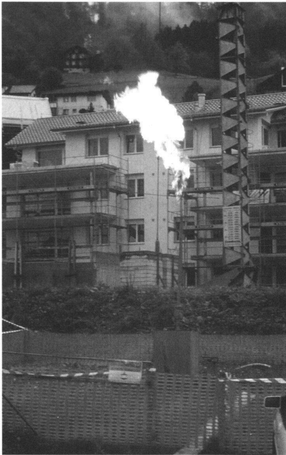
Fig. 4: Installierte Abfackelanlage mit kleiner Flamme.
