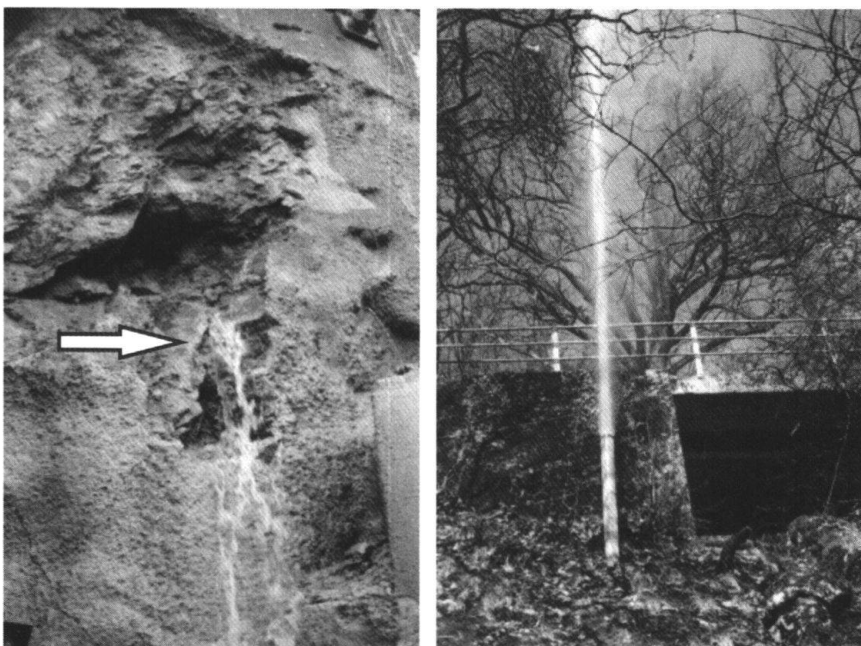
Fig. 10: Druckversuch vom 24.-25. April 1990: Aus dem Sondierstollen ausgepresste Wasser-Luft-Fontäne (links). Druckversuch vom Herbst 1989: Unkontrollierte Wasseraustritte aus der Ankerwand beim Ostportal des Ligerztunnels (rechts).
