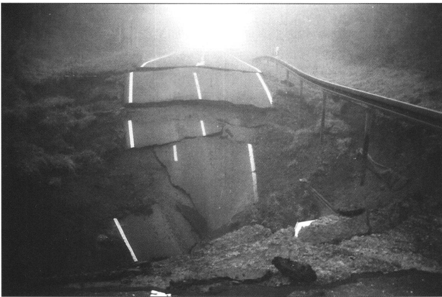
Fig. 9: Nachbruch des Erdalles auf der B 180 im Oktober 2001 mit vollständiger Zerstörung der Fahrbahn (Foto: Dauterstedt).
