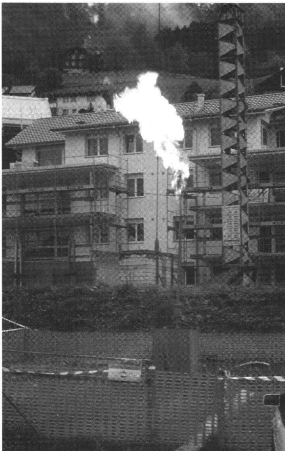
Fig. 4: Installierte Abfackelanlage mit kleiner Flamme.
