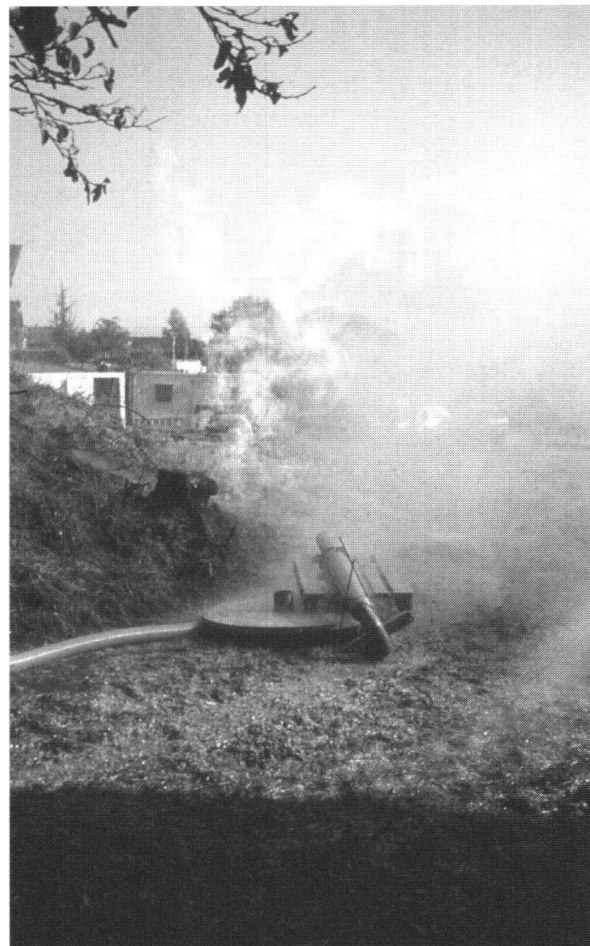
Fig. 3: Über die verlängerte Spülungsleitung wurde das Gas, in eine aus einem Futterrohr improvisiert hergestellte Fackel, abgeleitet. Das Futterrohr ist auf einem beschwerten Holzrahmen festgebunden und somit fixiert. In diesem Zustand gab es keine Möglichkeit, den Gasfluss zu stoppen.
