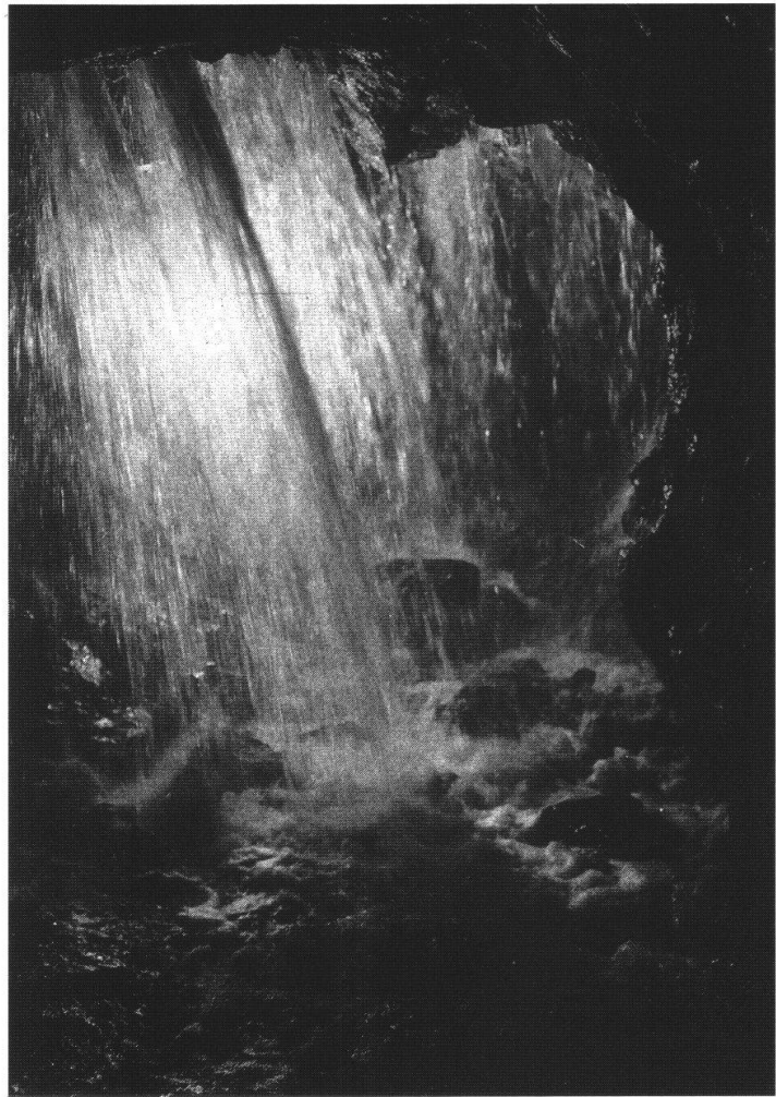
Fig. 5: Zulaufstollen Handeck-Chapf: Lokale Wassereintritte von ca. 400 l/sec.
