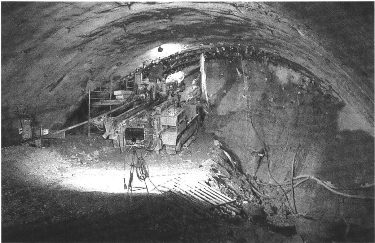
Fig. 8: Schadensbereich, Stat. 1066 nach Herstellung des ersten Rohrschirmabschnitts, Aufschlussbohrungen zur Erkundung des Verbruches.
