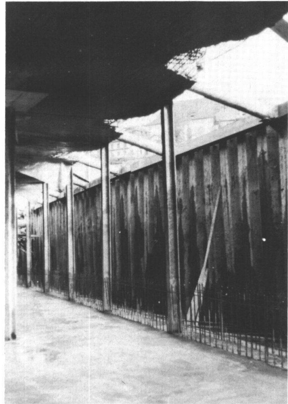
Abb. 14: Baugrubenabschluss, Verspriessung und Montage-Stützen. (Photo A. E. GONIN, Ingenieurbureau Dr. Staudacher & Siegenthaler AG, Bern).
