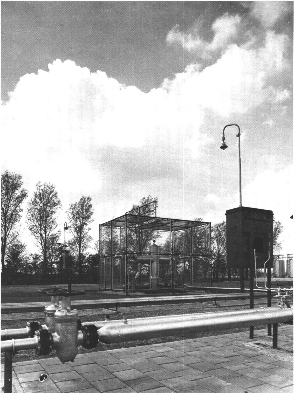
Fig. 5: Eine Bohrung auf Erdgas bei Slochteren (Groningen) wurde fündig. Absichern des Produktionskreuzes durch Eingitterung; saubere Installations- und Umgebungsarbeiten. Bei der Beurteilung des allfällig störenden Einflusses solcher Anlagen muss berücksichtigt werden, dass im günstigen Falle eine einzige Gasbohrung etwa viermal die Gesamtproduktionskapazität des Gaswerkes Schlieren (mit all seinen Anlagen) aufweisen kann!
