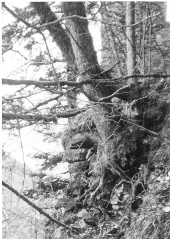
Abb. 4 «Vorburg», südliche Stützmauer, im Hinter- grund der Torpfeiler der Oberburg. Die extreme Topografie wird auf diesem Bild ebenso deutlich wie die Gefährdung der Trocken- mauer durch den Baumbewuchs.
