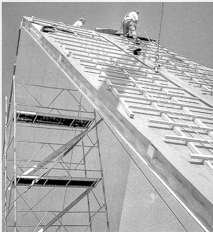
La reconstruction de la toiture du Werkhof en 2001 a constitué un défi technologique, les dalles Wellsteg n'ayant encore jamais été mises en œuvre sur une telle surface (ASBC, Jacques Vial)
