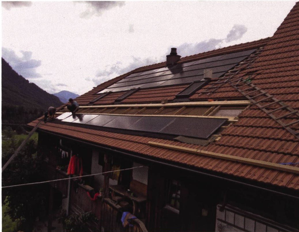
2010 wird eine Photovoltaikanlage installiert (Foto: Heidi Wendler)
