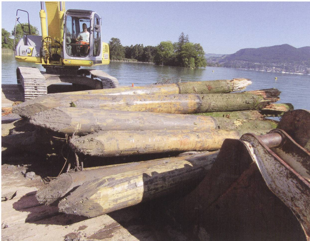
Abgebrochene Holzpfähle (Kissling + Zbinden)
