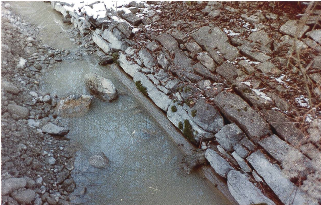
Das Trockenmauerwerk aus dem 19. Jahrhundert, das mit Holz unterlegt war, hielt über 100 Jahre.
