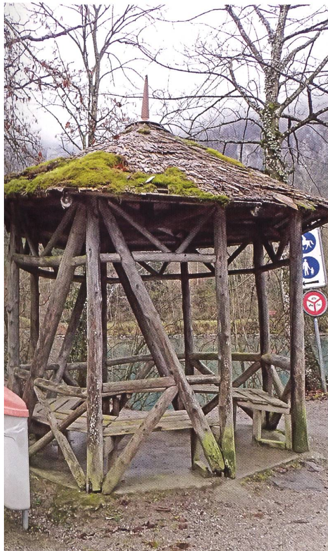
Abb. 4. Der alte, von Zerfallserscheinungen gekennzeichnete Pavillon beim Aareübergang
