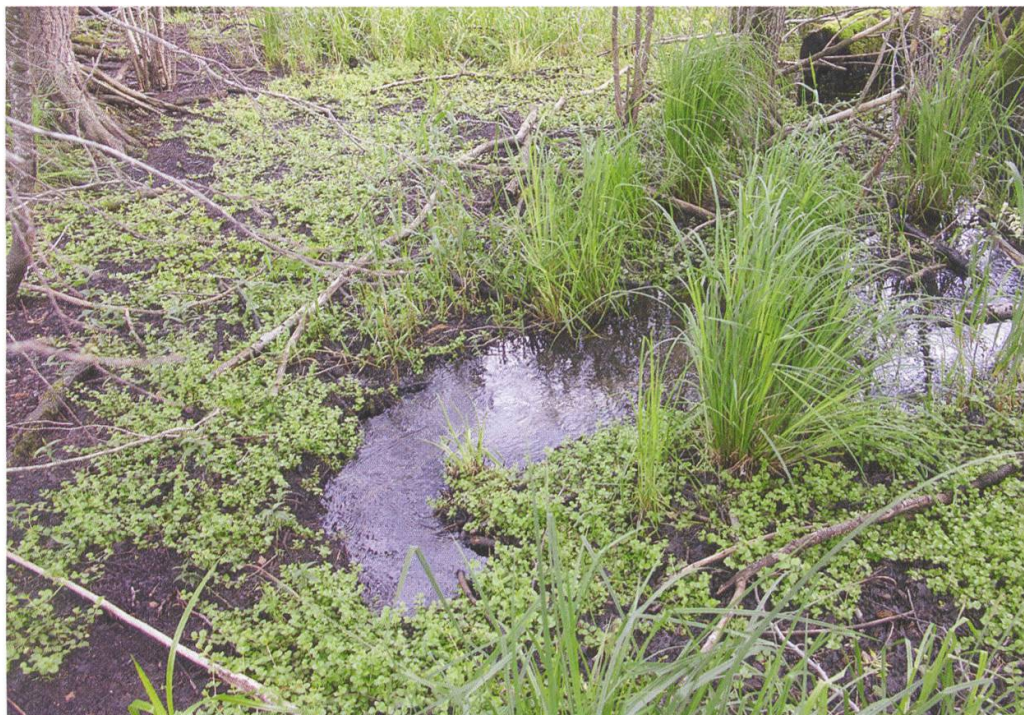
Einer der 10 Dammbrüche zwischen dem Amsoldingersee und dem Überlaufsee, 17. Juni 2015. Das Wasser sickert von links durch die Dammkrone und läuft dann oberflächlich in den Überlaufsee. (Foto: Kellerhals+Häfeli AG Bern)
