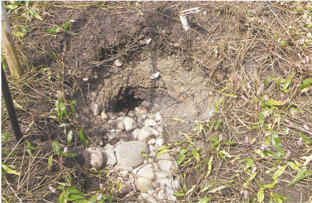
Einer der 7 Abläufe (Schlucklöcher) des Überlaufsees, 13. Juli 2015. Das vom Amsoldingersee her zufließende Wasser fließt durch solche offenen Löcher ab. Die Entstehung ist noch unklar. Eventuell handelt es sich um ehemalige Nagerlöcher. (Foto: Kellerhals+Häfeli AG Bern)
