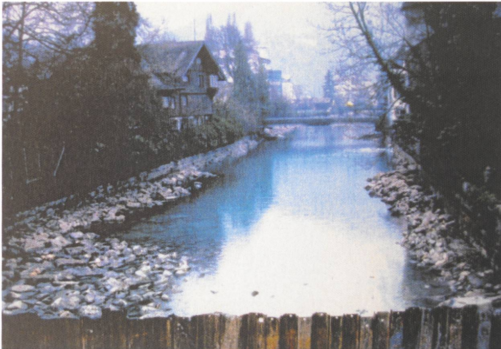
Abb. 7: Fehlender Kolkschutz (Foto: Benedikt Horn).
