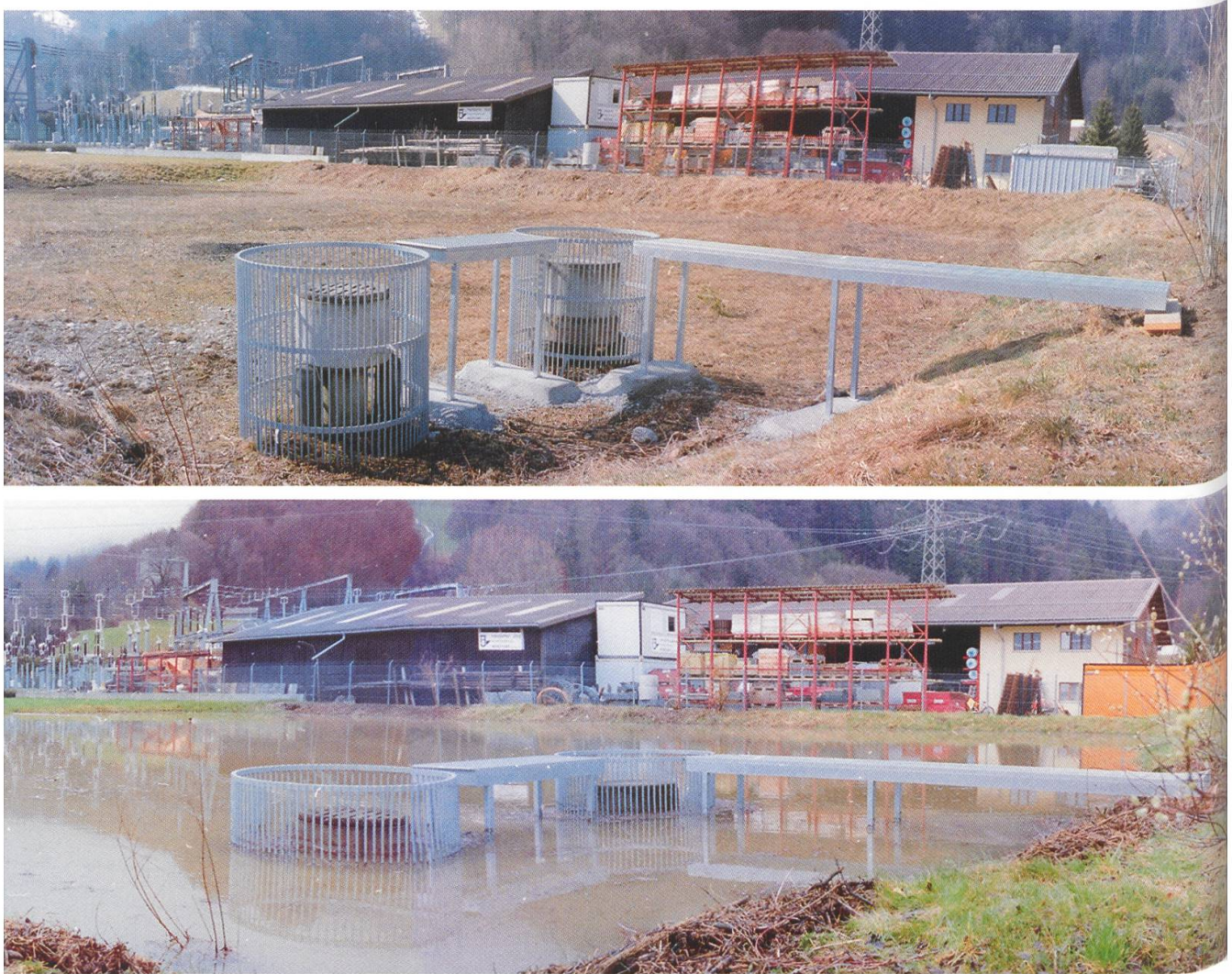
Abb. 18: Die Versickerungsanlage am 16. März 1993 und am 8. April 1993 – vor und nach Frost und anhaltendem Regen.
