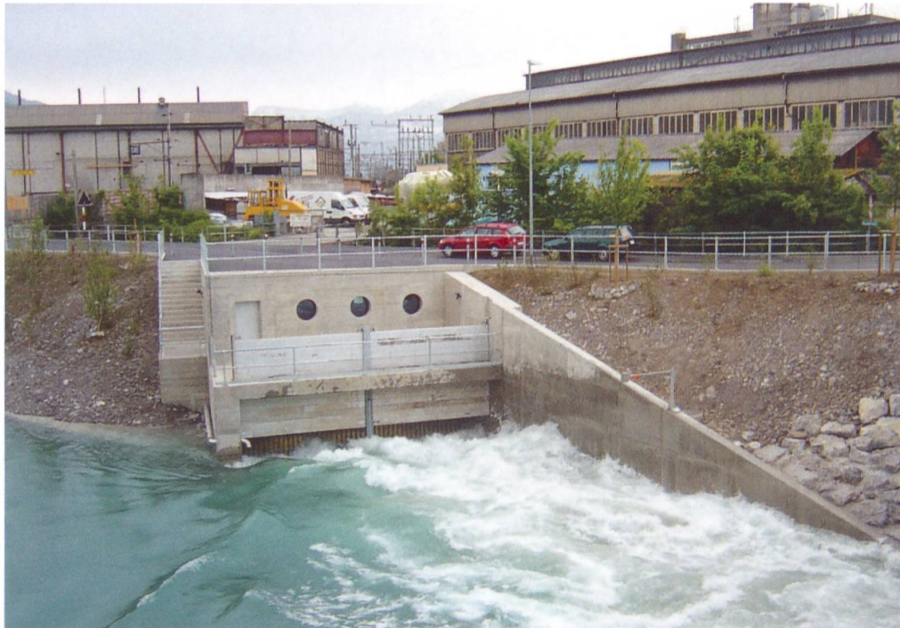
Auslaufbauwerk bei einem Ausfluss aus dem Stollen von knapp 90\text{m}^3/\text{Sek.} während den ersten Tests. (Quelle IC Infraconsult)
