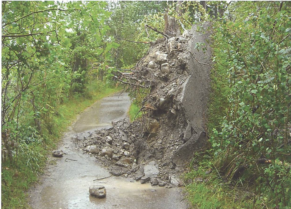
Sturmschaden vom 12. Juli 2011, der Wurzelballen der Föhre reisst den Uferweg auf. Foto: Andreas Fuchs
