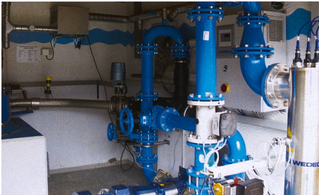
Steuerung der ganzen Wasserverteilung
