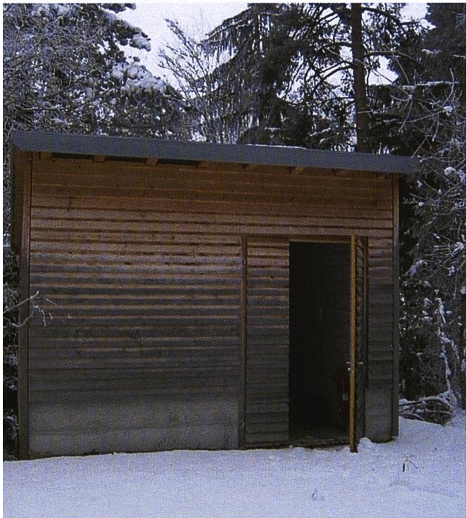
Aufbau auf dem Reservoir zur Erzeugung elektrischer Energie
