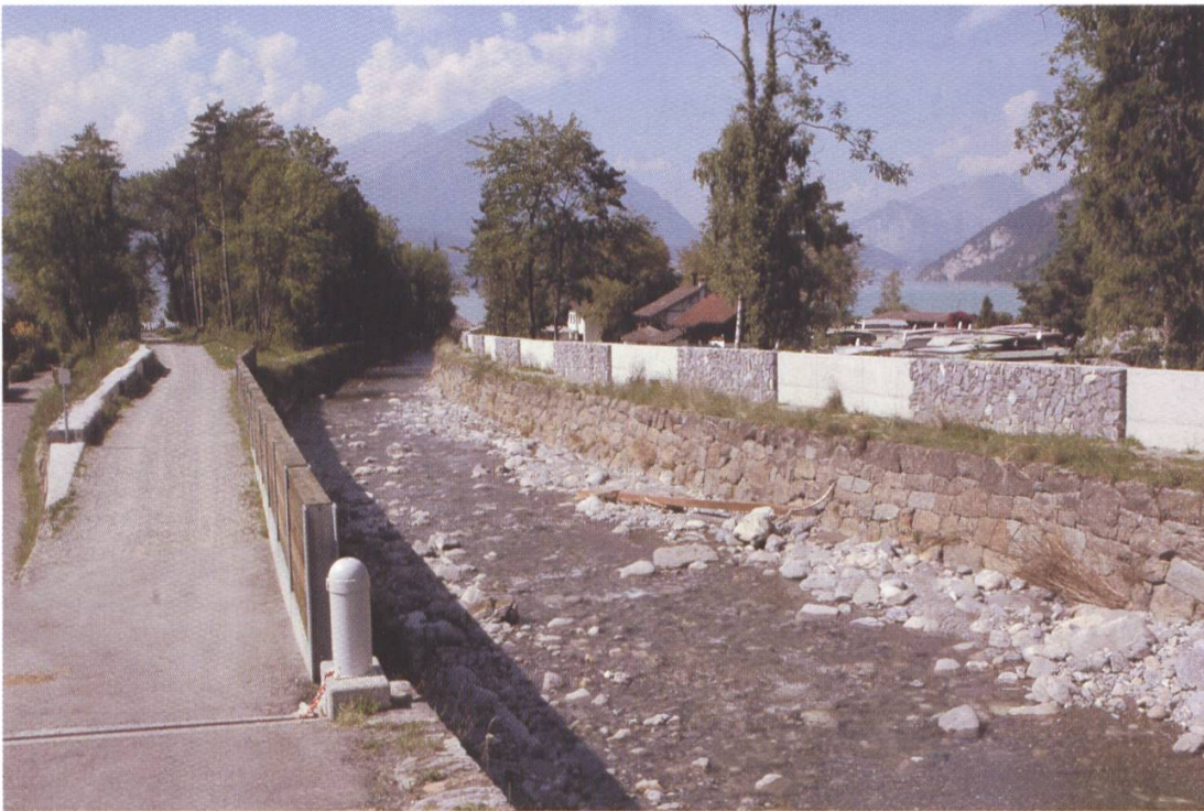
Hochwasserschutz-Verbauungen unterhalb der Neuhausbrücke: Der zu einem Schutzdamm ausgestaltete Kiestransportweg (links), angrenzend eine Holzbalkenwand und am rechten Ufer eine Hochwasser-Steinmauer (Betonkern mit Steinverkleidung). Foto: Ueli Flück
