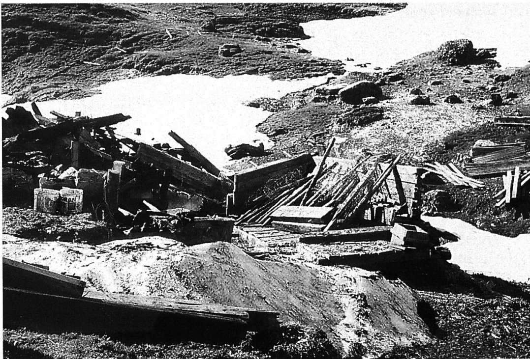
Lawinenschaden an einer Alphütte
