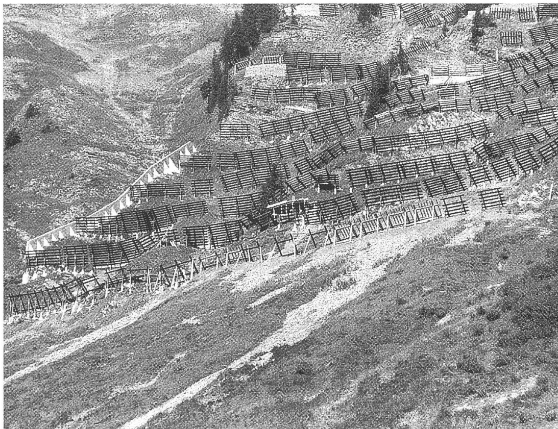
Abbildung 21: Eine Betonleitwand von 2,5—5,0 m Höhe schützt hier Teile der Stützverbauungen am Wilerhorn / Brienzwiler vor Einbrüchen schwerer und häufiger Lawinen aus unverbauten Teilgebieten.
