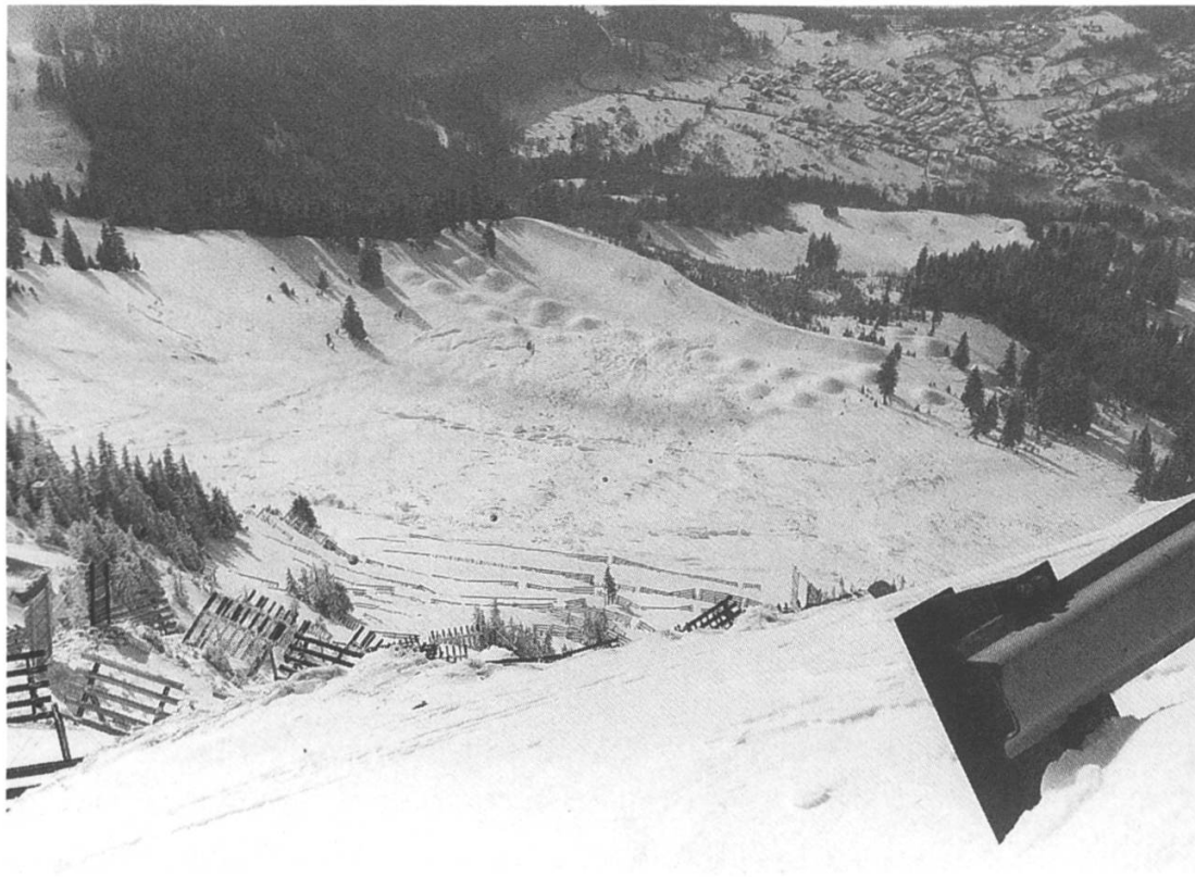
Abbildung 22: Gesamtübersicht der Lawinenverbauungen Wilerhorn / Alpogli zum Schutz des Dorfes Brienzwiler. Im Vordergrund Stützverbauungen am Wilerhorn, in der Bildmitte die Bremsverbauung Alpogli auf ca. 1340 m ü. M. mit zum Teil von Lawinmassen überdeckten Bremshöckern und dem 225 m langen Auffangdamm, darunter die 7,8 ha grosse Lawinschneise von 1945—62 in den Schutzwaldungen.
