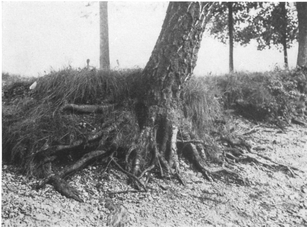
Am Strandweg Bönigen U. Brunner Vom Wellenschlag unterspülte Baumwurzeln. Hier haben wir Ufersicherungen gebaut
