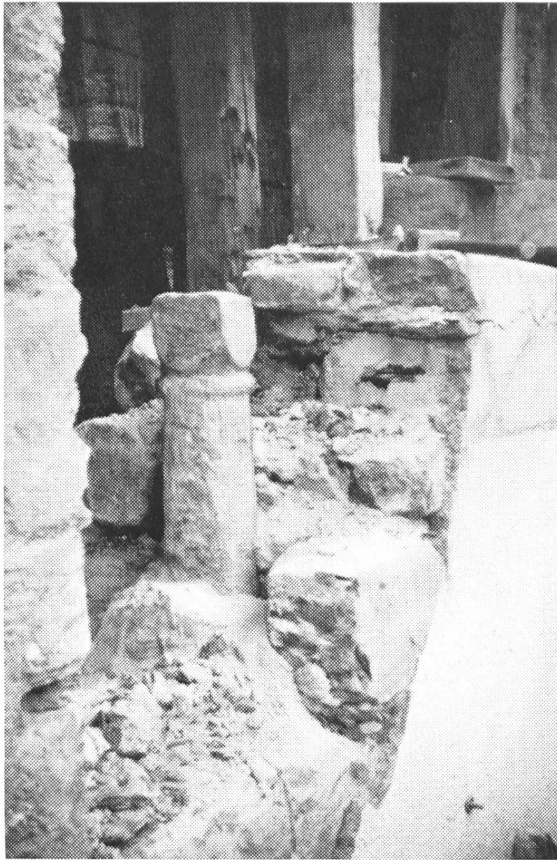
Vierteiliges Fenster (Seeseite) Mauerausbruch
