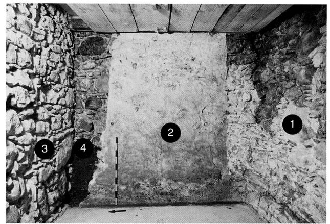
Abb. 5 Seehof, Erdgeschoss, Südostrraum, Blick Richtung Osten, Befunde teilweise freigelegt. 1 Stadtmauer. 2 Westwand der Liebfrauenkapelle (Aussenseite). 3 Interne Trennwand des Seehofes. 4 Unterkante der Kapellenwand (ca. 0,8 m über dem modernen Boden). Die Fundamentunterkante der Stadtmauer im Bereich zwischen modernem Boden und Fundamentunterkante der Kapellen-Westwand konnte nicht genau bestimmt werden.
