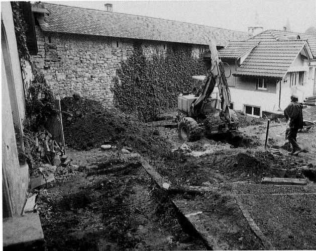
Abb. 22 Liegenschaft Bohlstrasse 7, Blick Richtung Nordwesten. Aussenseite der Stadtmauer. Sondierungsarbeiten mit dem Bagger.
