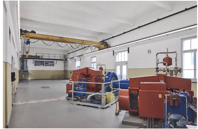
Abb. 3 Baar, Haldenstrasse 7, «Zentrale 3». Blick nach Westen zur Kommandozentrale. Im Vordergrund die neuen Turbinen in der sorgfältig sanierten Maschinenhalle mit den nach Befund gestrichenen Wänden.
