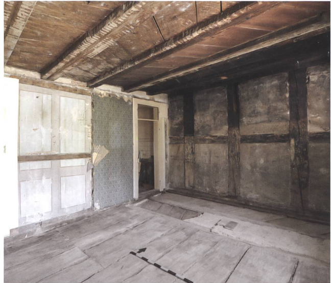
Abb. 41 Zug, Neugasse 17. Östlicher Raum der Fachwerkerweiterung von 1605/06, mit massiven Ständern und Riegelband. Links eine nachträglich eingefügte Binnenwand. Originaler Bodenaufbau mit Blindbodenbrettern, Estrichmörtel und Bodenbrettern/Plattenboden.
