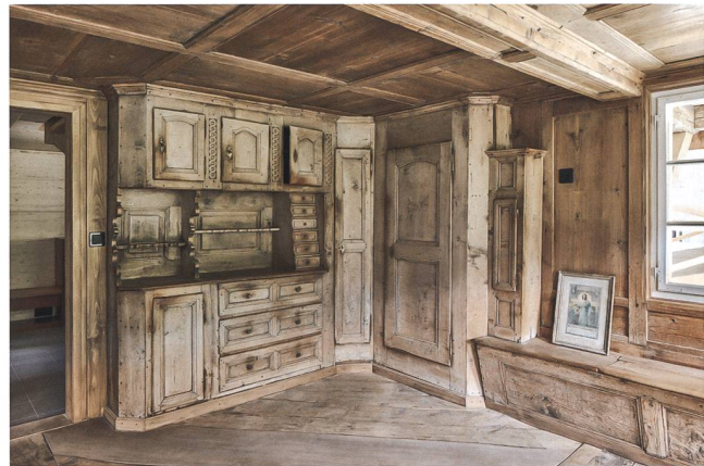
Abb. 4 Der Charme der alten Stube bleibt auch nach dem Umbau bestehen. Erst bei genauer Betrachtung fallen die einzelnen Hölzer und Bauteile auf, die ersetzt werden mussten.
