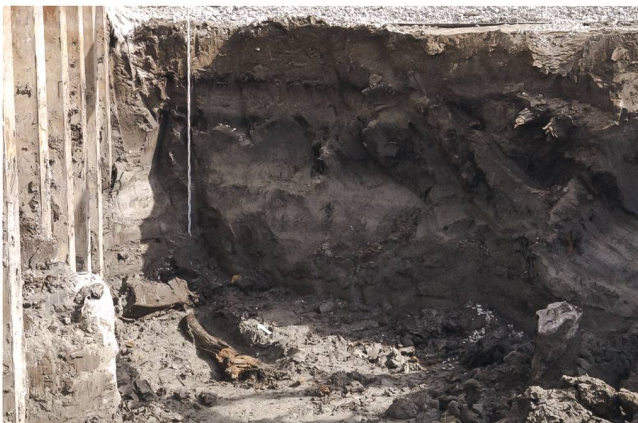
Abb. 1 Baar, Grabenstrasse 2. Baustellensituation mit Profil in der Aushubkante. Im Vordergrund liegt das beprobte Holz.
