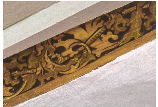
Abb. 2 Untere Münz. Stube im zweiten Obergeschoss. Freigelegter Balken mit flachem, floralem Schnitzwerk.
