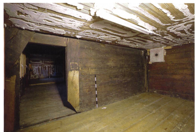
Abb. 20 Hünenberg, Dorfstrasse 2. Reste der Bohlenständerkonstruktion aus der Zeit um 1472/73. Die Türöffnung mit Mantelständer stammt aus einem späteren Umbau.
