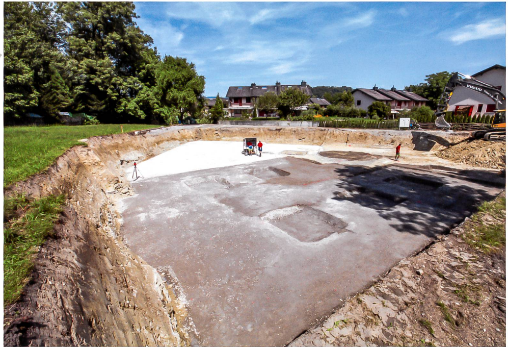
Abb. 10 Cham, Hagendorn, Dorfstrasse 25. Übersicht über den Bauplatz nach Abschluss des Aushubs für den Neubau.
