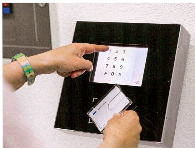
Abb. 1 Die Bedienung der Sicherheitsanlage erfolgt mittels Touchscreen-Terminal. Zutrittskontrolle, Alarmmanagement und organisatorische Massnahmen gewährleisten eine hohe Sicherheit.
