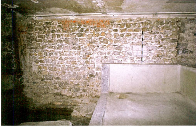
Abb. 51 Zug, Grabenstrasse 10, Wohnhaus. Im Erdgeschoss freigelegtes Mauerwerk, das an die Ringmauer (rechts) anstösst. Die westliche Begrenzung (links) bildet das Gewände einer originalen Türe. Blick nach Norden.
